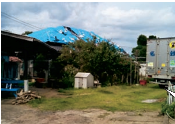
写真 3 屋根をブルーシートで覆った家
