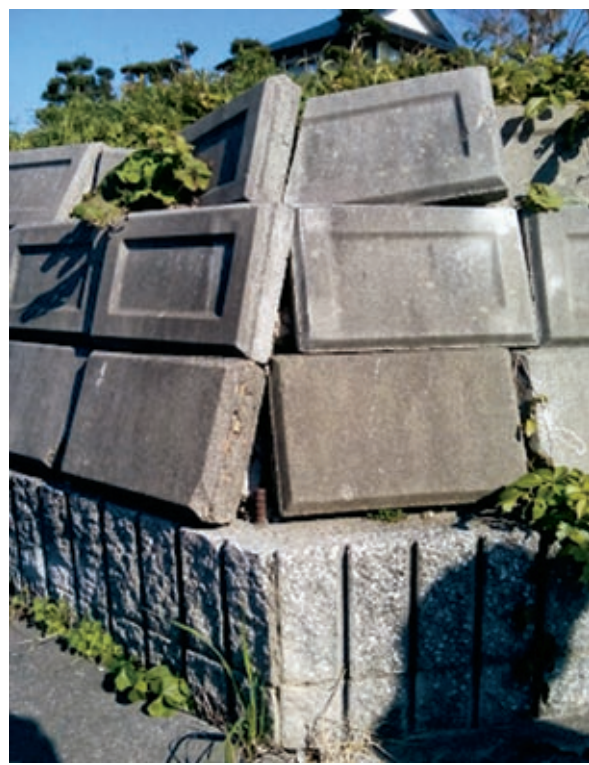
写真7 地震で崩れて放置されたままの塀
