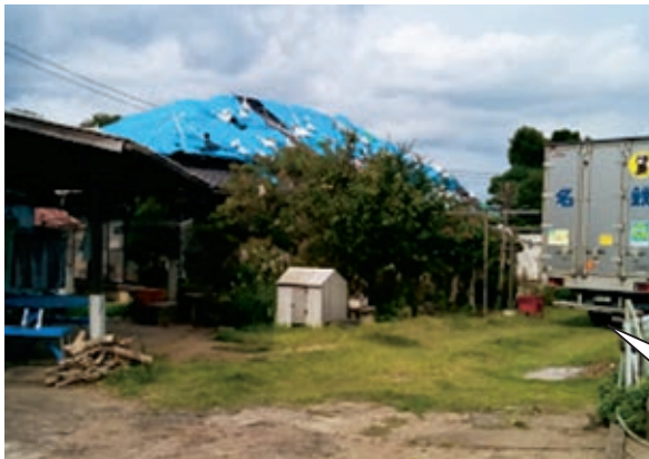
写真 3 屋根をブルーシートで覆った家
